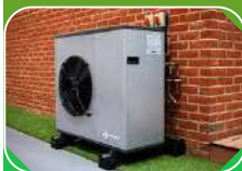
Αντλίες Θερμότητας και Τηλεθέρμανση/Τηλεψύξη
